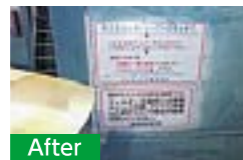
After 張り替えにより改善
