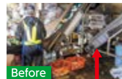
Before 点検清掃時に 巻き込まれの危険あり
