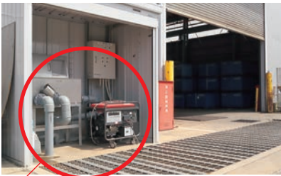
地下貯水槽に溜まった雨水をポンプで汲み上げ油水分離槽へ
